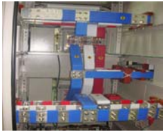
銅排整體經過電鍍光亮錫工藝處理 通過絕緣熱縮管進行絕緣處理及相序標記
